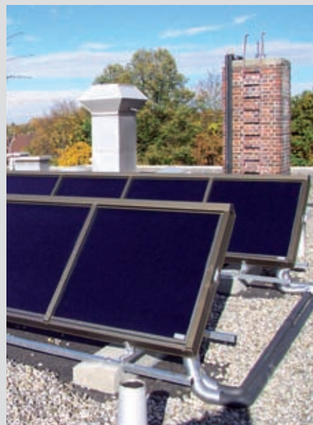
Mehrfamilienhaus, 24 m 2 Solarkollektoren zur Warmwasserbereitung
